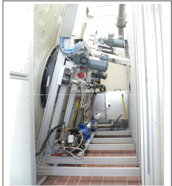
Voorbeeld: Technische ruimte in het achterste gedeelte van de SPZ-K...Classic Line en Basic Line
